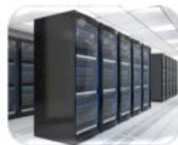
データセンター
